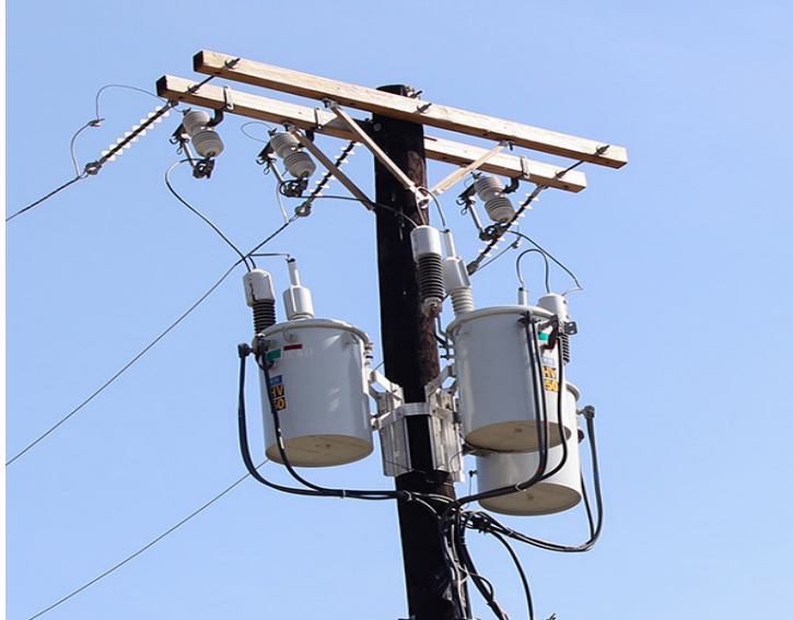
Transformadores tipo Poste, ya sea monofásico o trifásico
